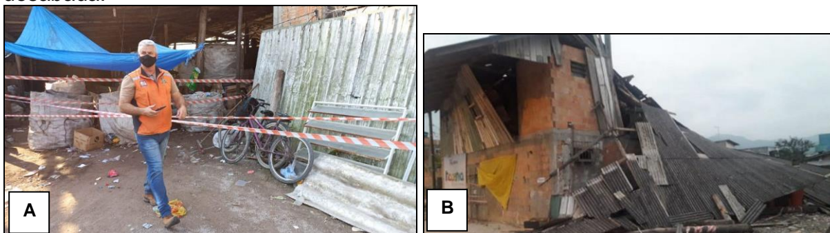
Figura 27 - A) Interdição da Cooperitapema pela Defesa Civil; B) Parte da estrutura desabada.
