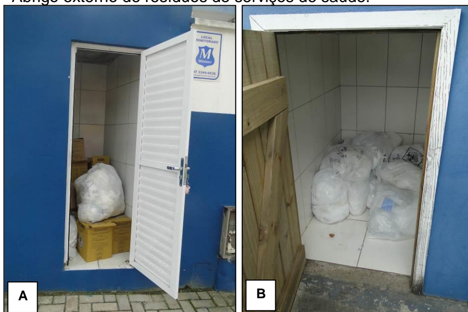
Figura 53 - Abrigo externo de resíduos de serviços de saúde.
