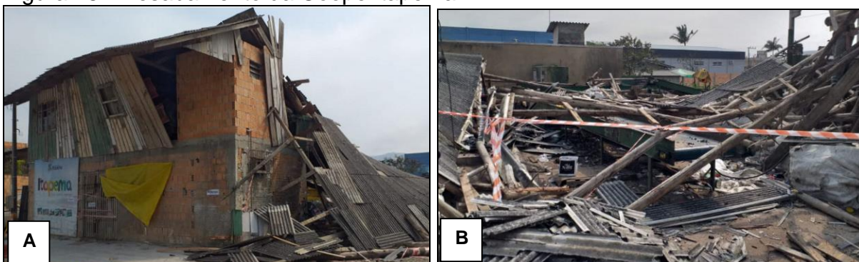
Figura 28 - Desabamento da Cooperitapema.
