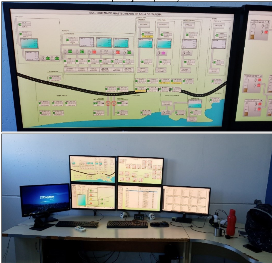
Figura 26 - Centro de Controle de Operações (CCO) do SAA e SES.
