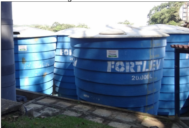
Figura 56 - Reservatórios de água tratada.
