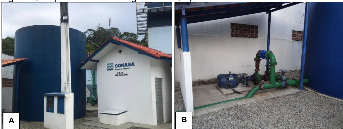
Figura 49 - A) Reservatório de água tratada; B) ERAT São Paulinho.
