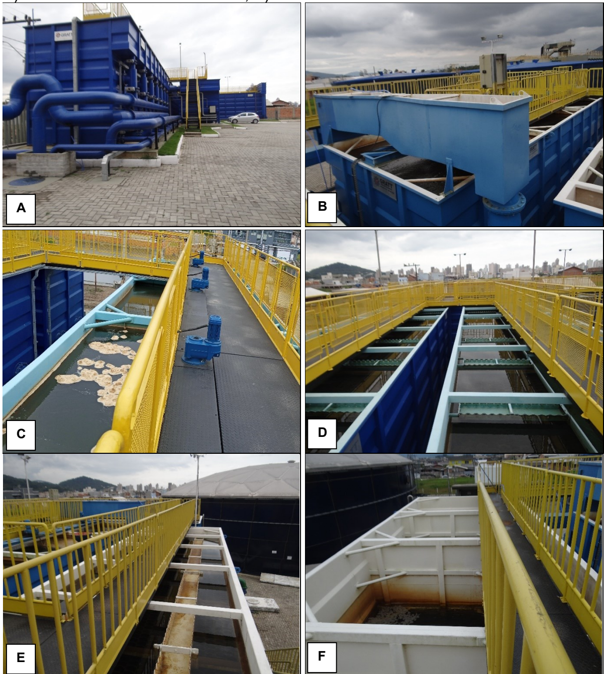
Figura 21 - A) ETA 2 e ETA 3; B) Calha parshall; C) Floculadores mecânicos ETA 3; D) Decantadores lamelares ETA 3; E) Filtros descendentes ETA 2.
