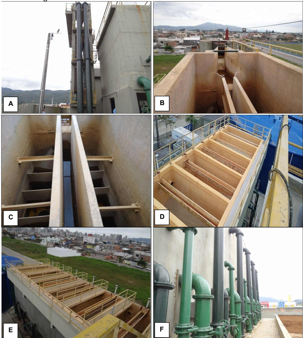
Figura 18 - A) Coluna de adutoras de água bruta; B) Calha parshall; C) Caixa de distribuição de fluxo; D) Conjunto de seis filtros ascendentes; E) segundo conjunto de seis filtros ascendentes; F) Detalhe de tubulações de saída de água clarificada e água de retrolavagem.
