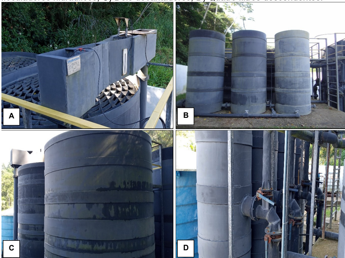
Figura 55 - A) Calha parshall e superfície de decantador lamelar ao fundo; B) Três flocluladores hidráulicos; C) Dois decantadores; D) Quatro filtros descendentes.
