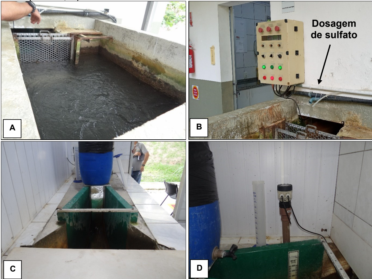
Figura 37 - A) Caixa de entrada da água bruta; B) Dosagem de sulfato de alumínio; C) Calha parshall; D) Medidor de vazão ultrassônico.
