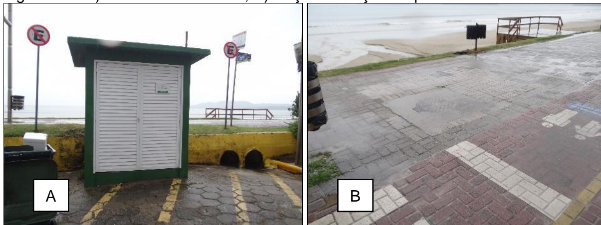
Figura 49 - A) Elevatória EEE-277; B) Poço de sucção no passeio.
