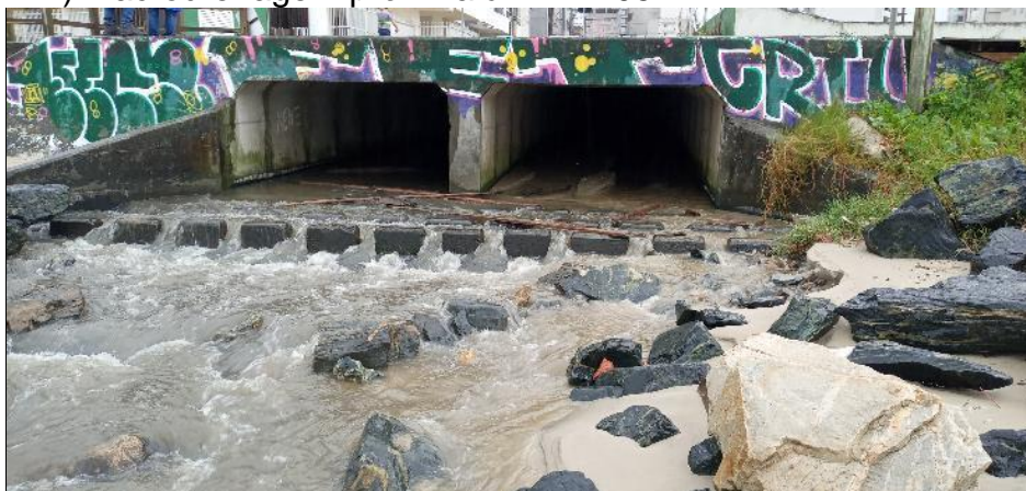
Figura 54 - A) Macrodrenagem próxima à EEE-205.
