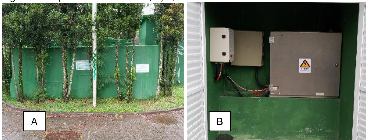
Figura 48 - A) Elevatória EEE-306; B) Quadro de comando.
