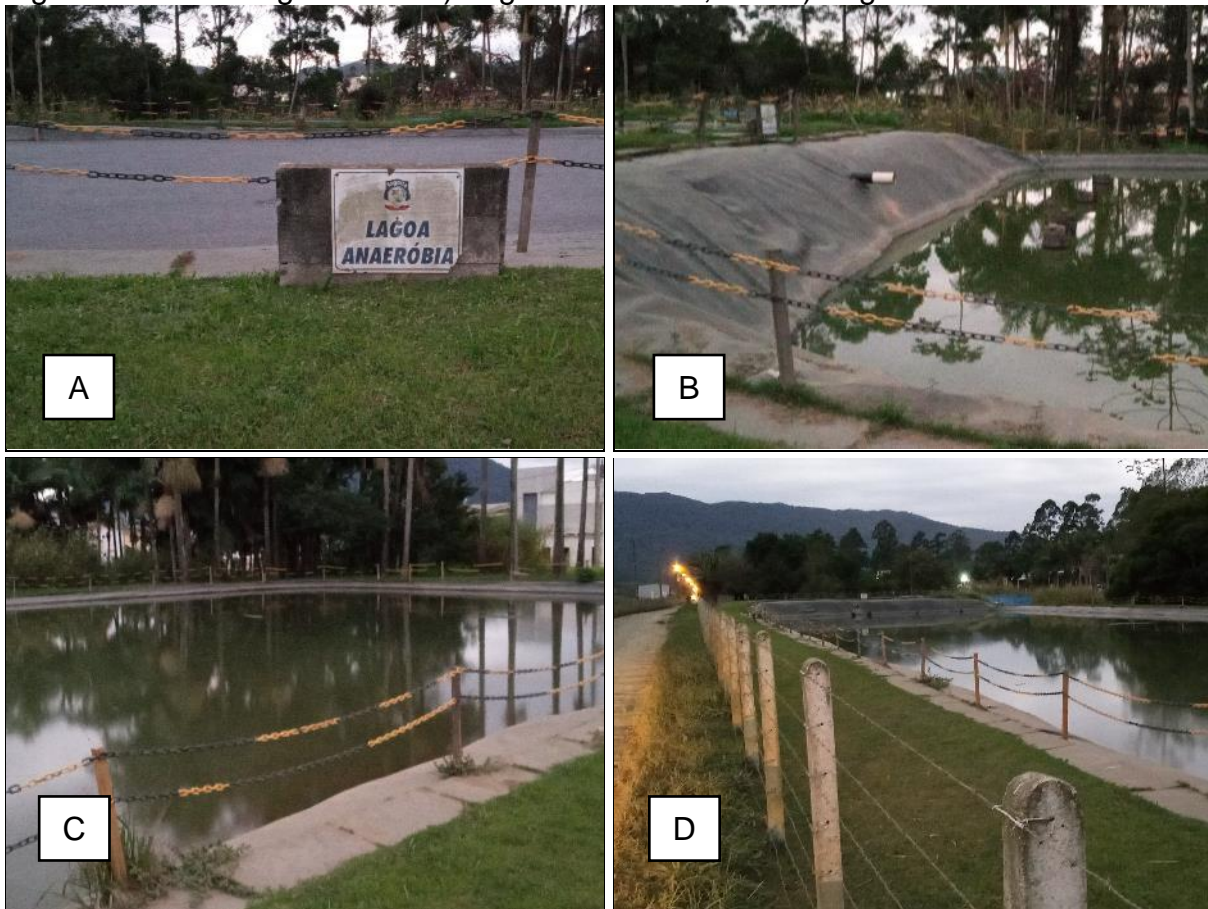
Figura 29 - ETE Esgóita. A e B) Lagoa anaeróbia; C e D) Lagoa facultativa.
