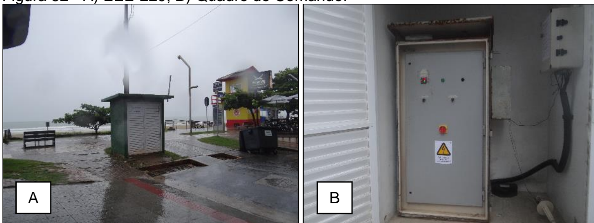
Figura 52 - A) EEE-229; B) Quadro de Comando.
