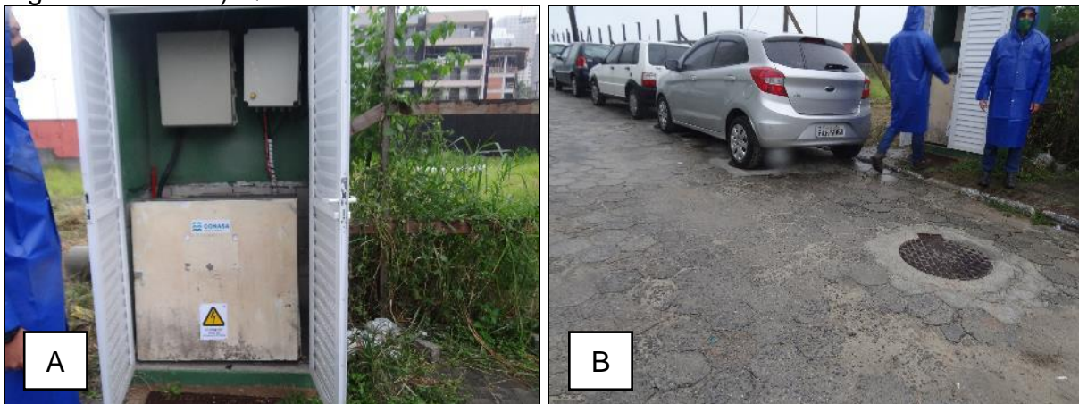
Figura 45 - A e B) Quadro de comando EEE-201.
