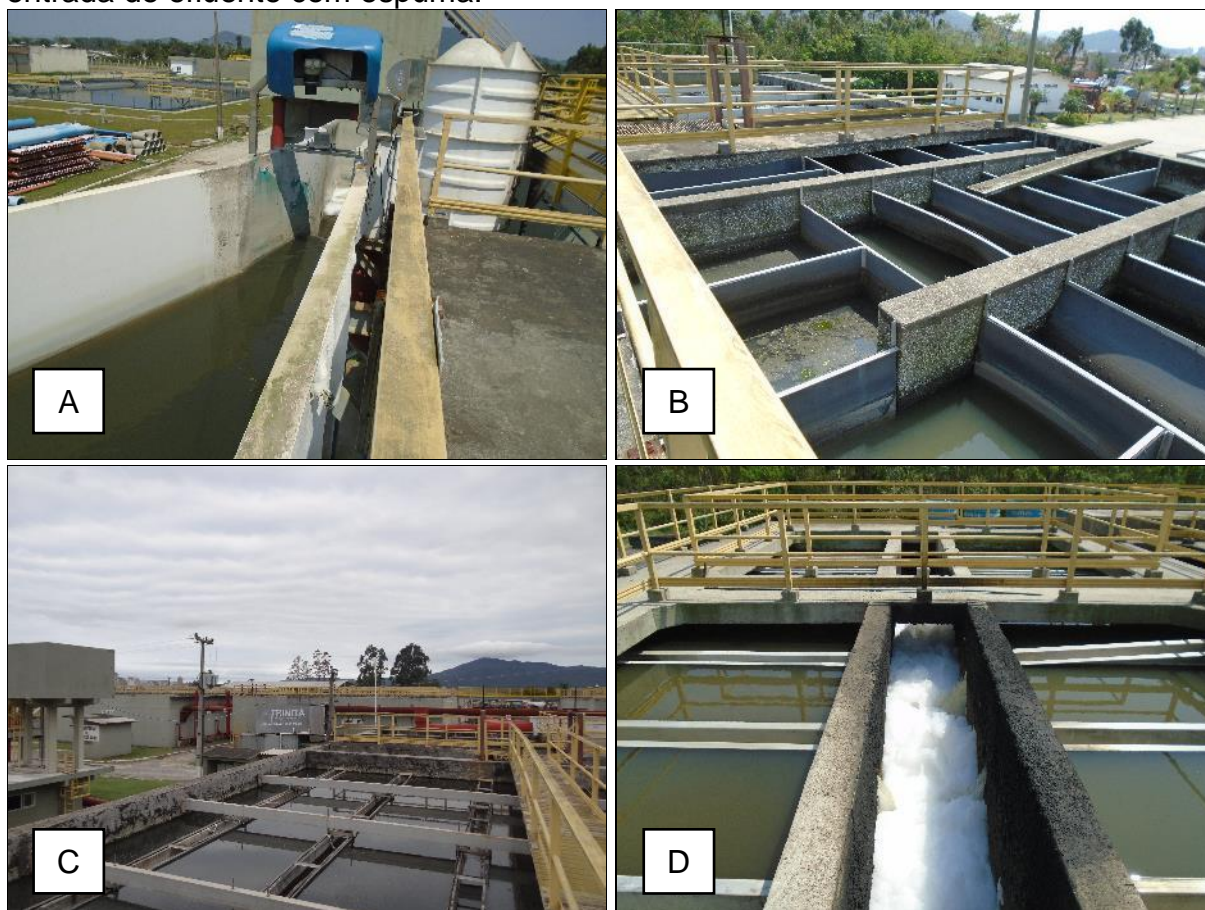
Figura 71 - A) Calha parshall com medidor de vazão na entrada dos floco-decantadores; B) floculador hidráulico; C) decantador de alta taxa; D e) canais de saída do efluente com espuma do decantador; F) tanque de contato de cloro com entrada de efluente com espuma.
