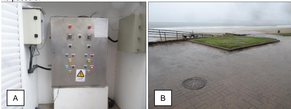
Figura 50 - A) Quadro de comando EEE-237; B) Poços de grade, sucção e manobra no passeio.
