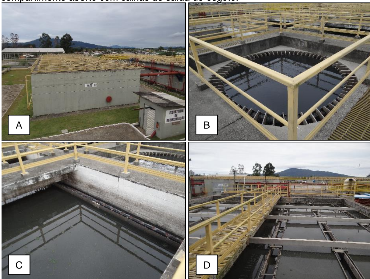
Figura 70 - A) Vista de Reator UASB; B) Distribuidor de vazão com vertedores; C) vista de compartimento superior aberto com retentor de espuma; D) vista superior do compartimento aberto com calhas de saída do esgoto.
