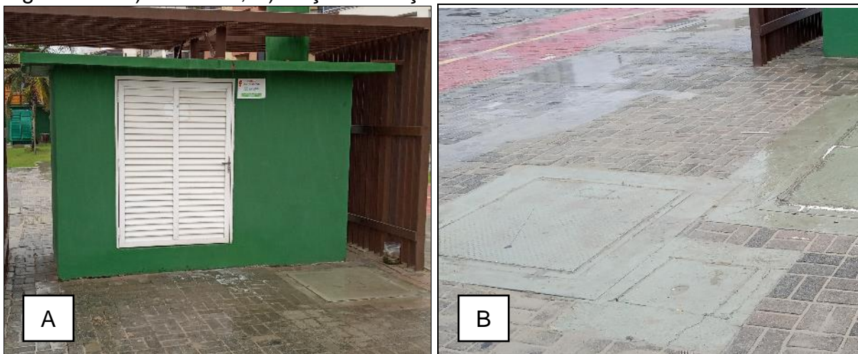
Figura 53 - A) EEE-205; B) Poço de sucção.
