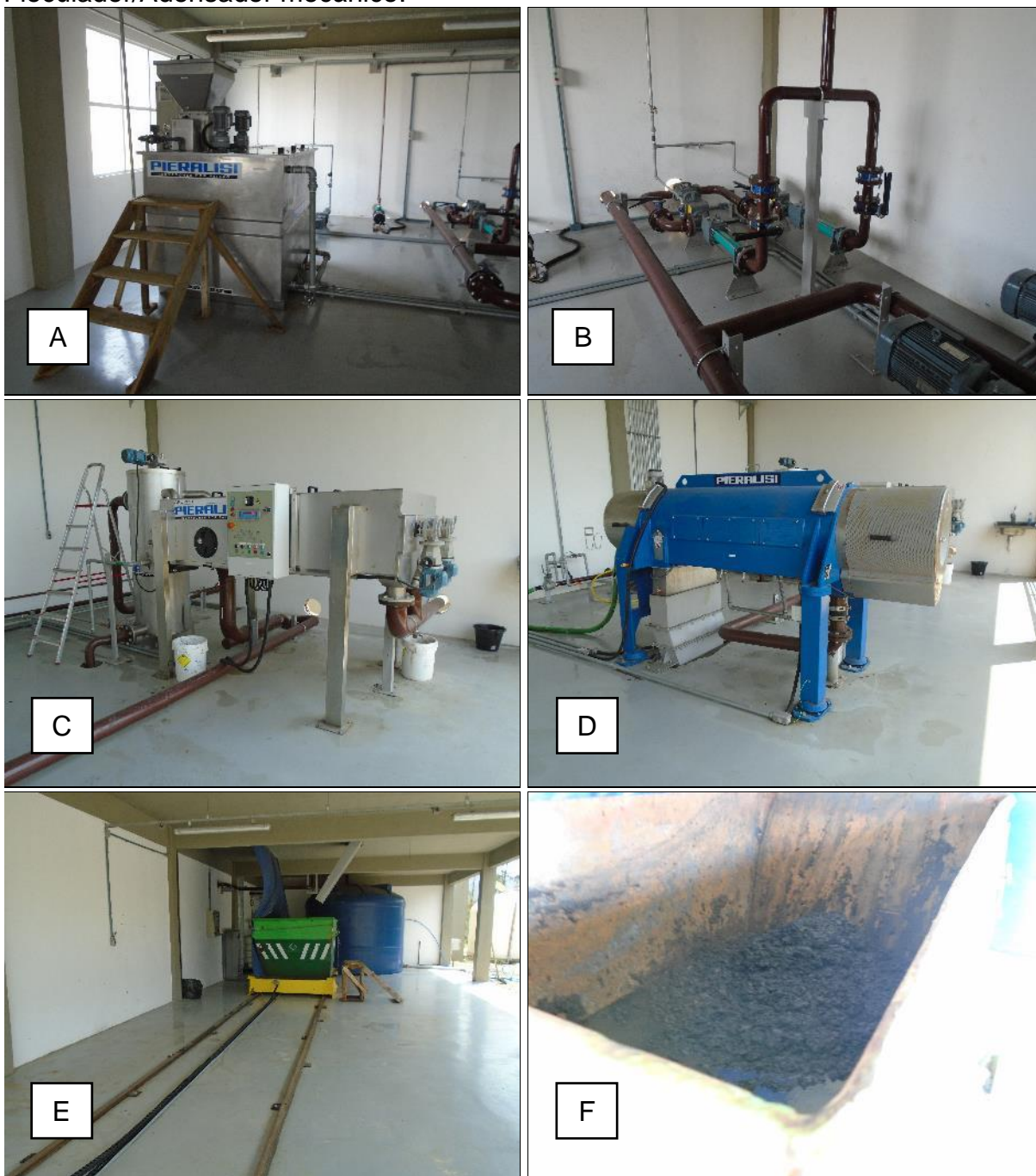
Figura 74 - A) Sistemas de preparo/dosagem polímero para adensamento e desaguamento de lodo; B) bomba recalque lodo adensado para desaguamento; C) Floculador/Adensador mecânico.
