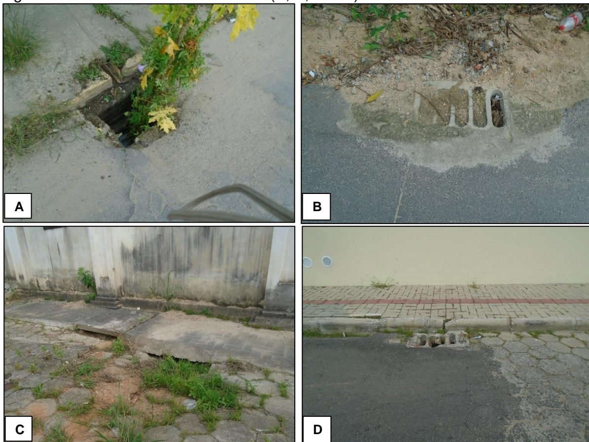
Figura 38 - Bocas de lobo danificadas (A, B, C e D).
