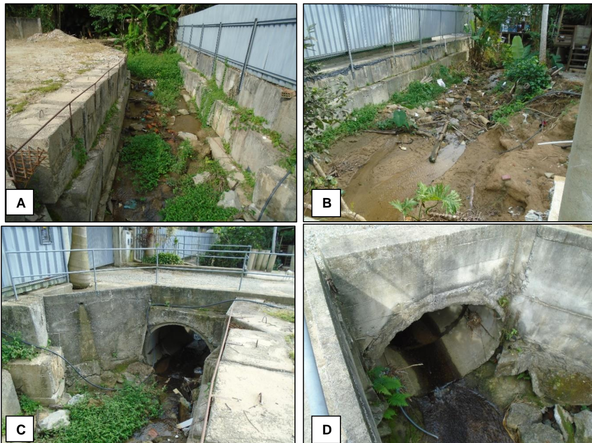
Figura 10 - A) Córrego a montante; B) Córrego a jusante; e C e D) Tubulação de travessia.
