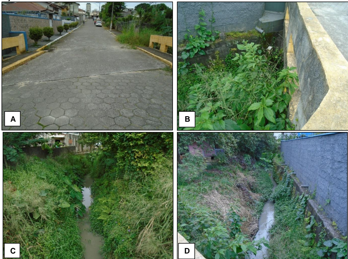
Figura 33 - A) Geral da via; B) Seção da ponte; C) Córrego a montante; e D) Córrego a jusante.
