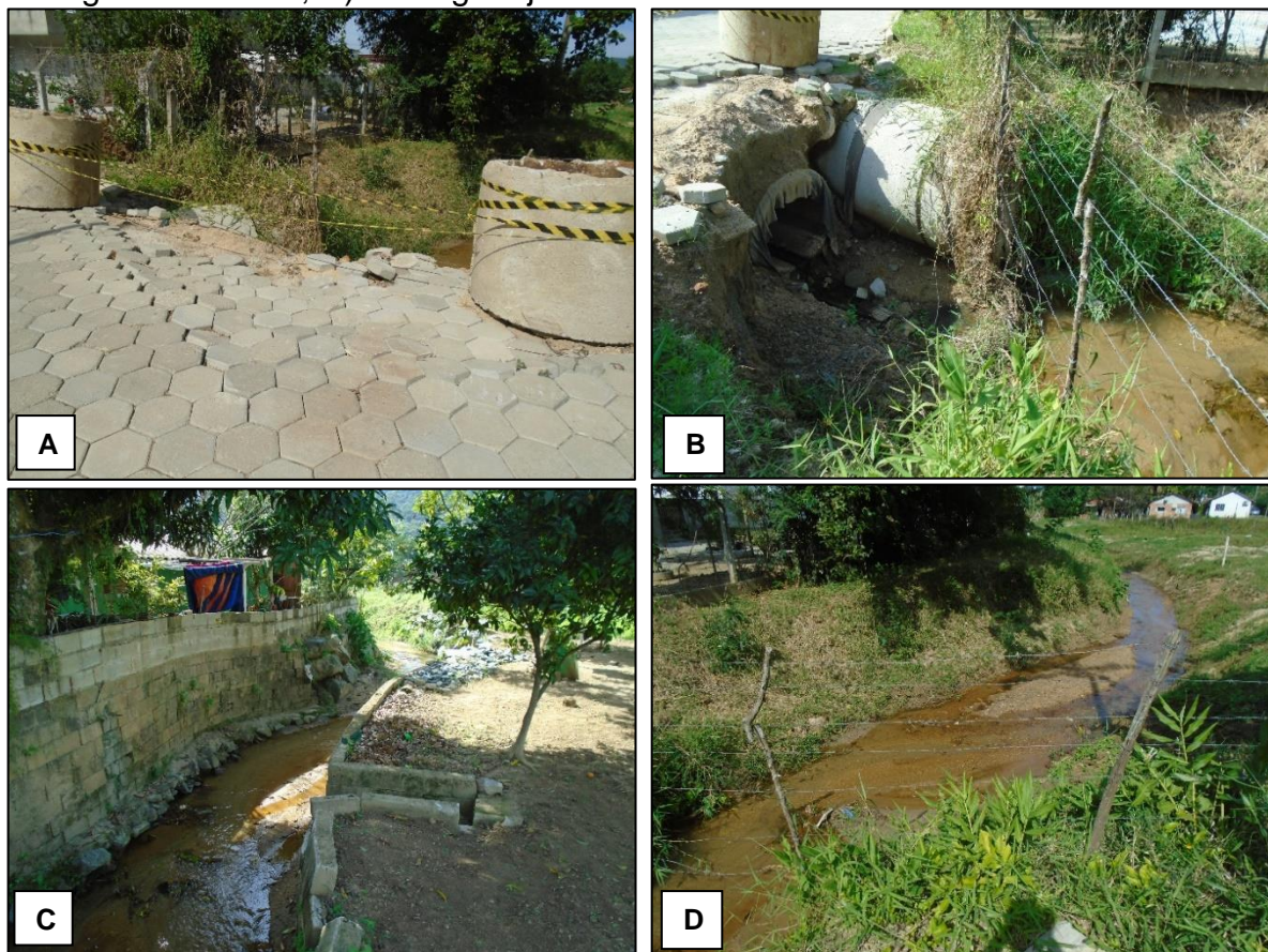
Figura 52 - A) Trecho da via danificado; B) Bueiro duplo tubular de concreto; C) Córrego a montante; D) Córrego a jusante.
