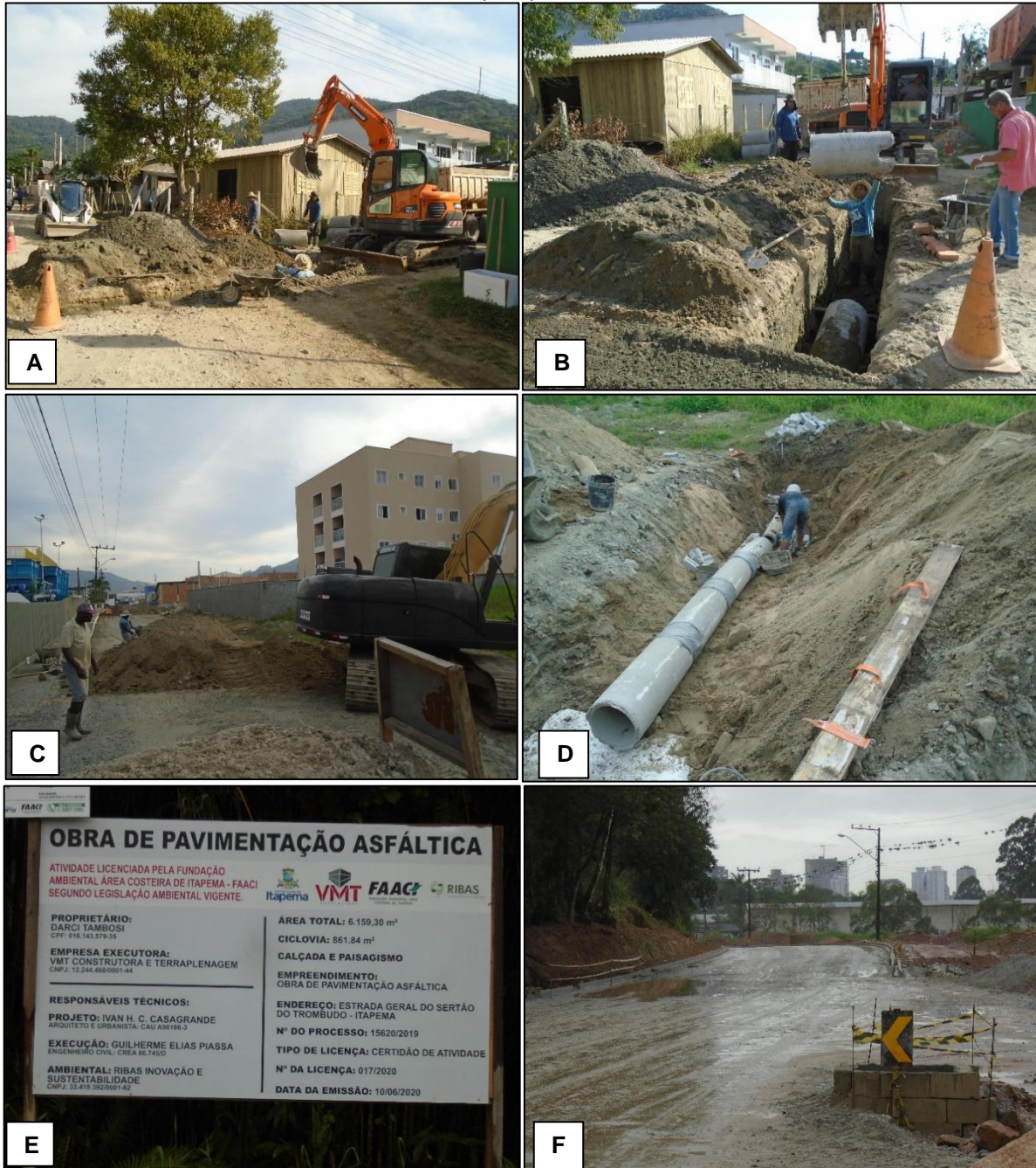
Figura 82 - A e B) Rua 1204 B2 bairro Ilhota; C e D) Rua 422 no bairro Morretes; Estrada Geral do Sertão do Trombudo (E F).
