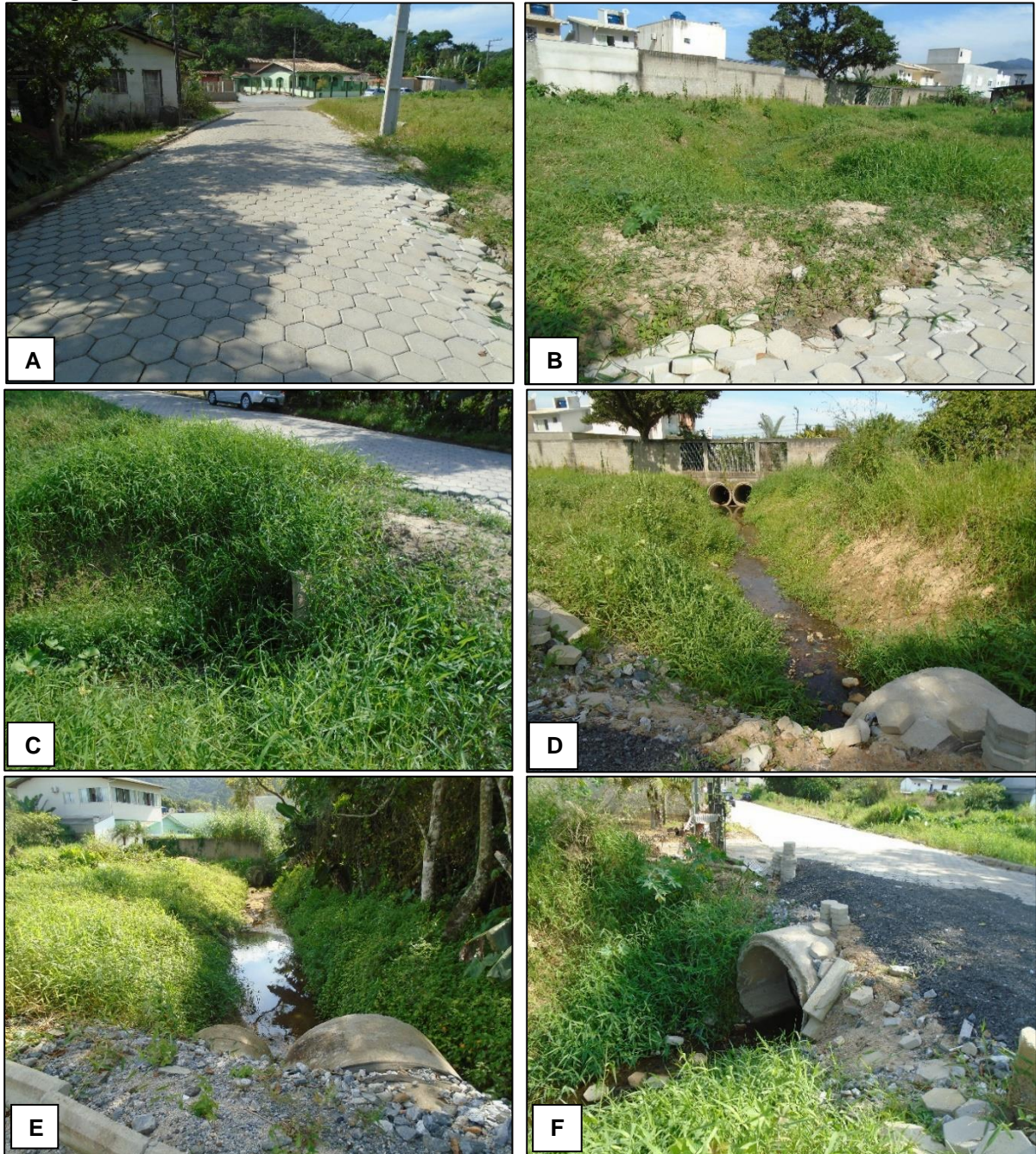
Figura 51 - A) Vista geral da via; B e C) Córrego; D) Córrego a jusante; e E e F) Córrego a montante.
