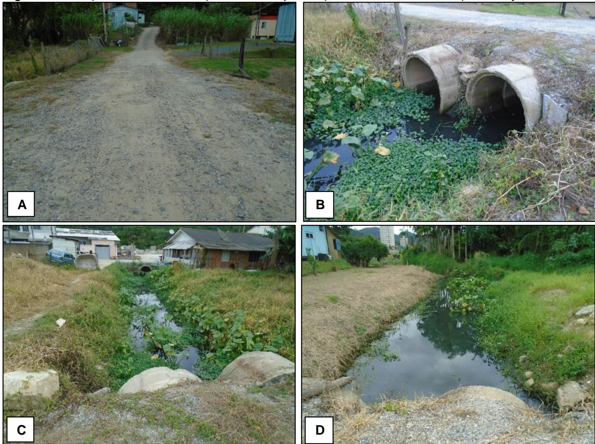
Figura 23 - A) Geral da via; B) Bueiro duplo; C) Rio a montante; D) Rio a jusante.
