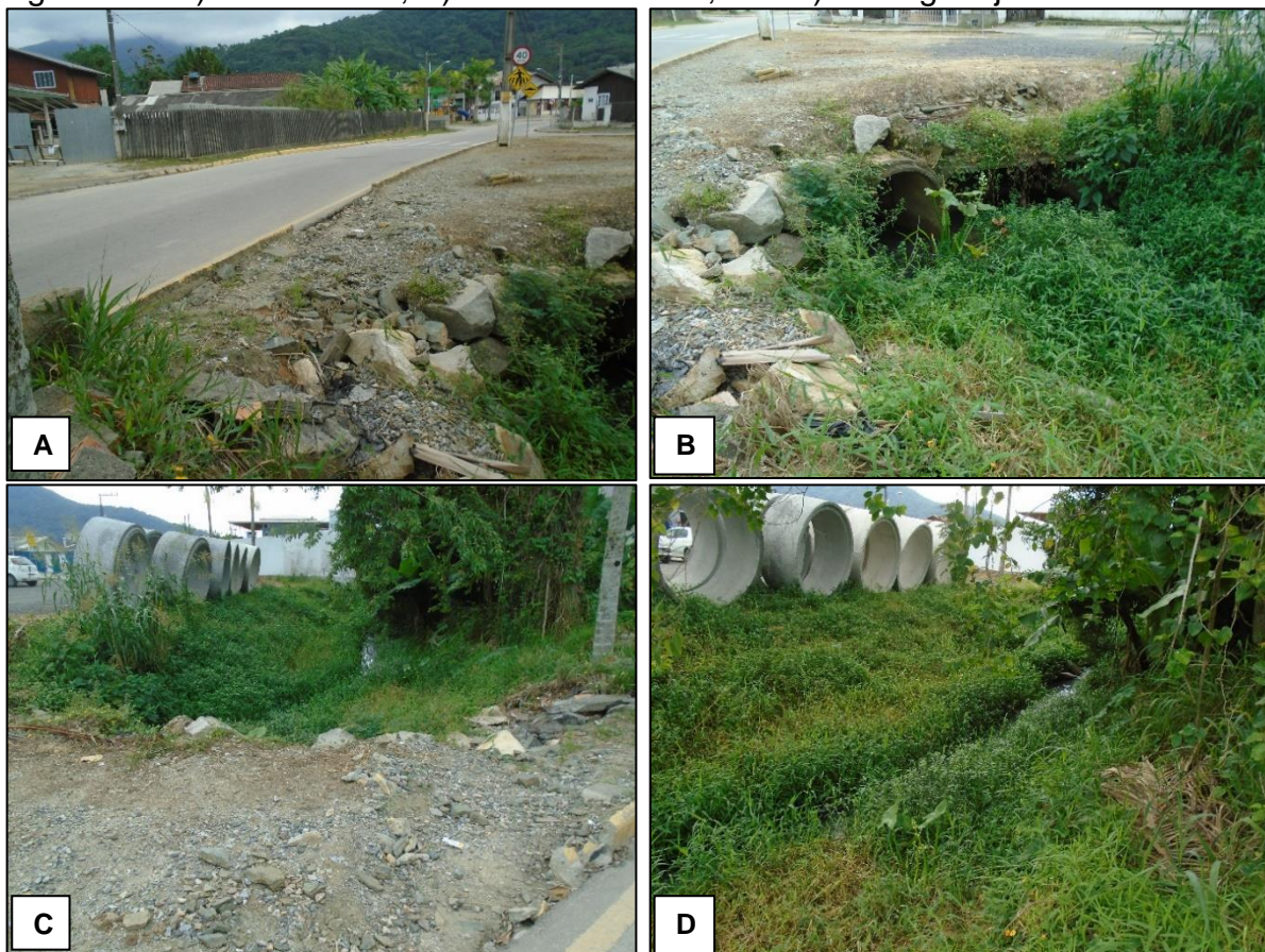
Figura 48 - A) Geral da via; B) Bueiro existente; C e D) Córrego a jusante.
