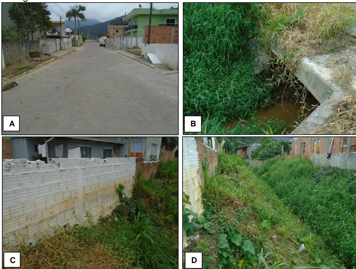
Figura 45 - A) Geral da via; B) Bueiro de concreto; C) Marca d'água enxurrada; D) Córrego a montante.
