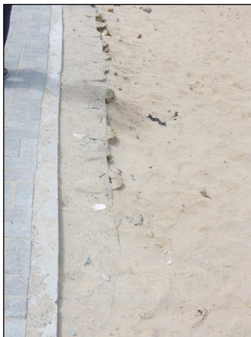
Figura 114: Contenção implantada na orla do município de Itapema tendo em vista a minimização dos impactos ocasionados pela erosão costeira no Parque Linear implantado.
