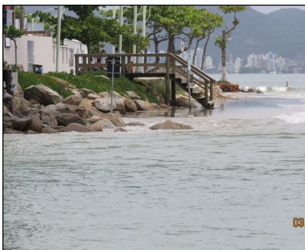
Figura 111: Enrocamento realizado de forma paliativa na foz do Rio Perequê no município de Itapema tendo em vista a contenção dos processos de erosão praias já comumente observados.
