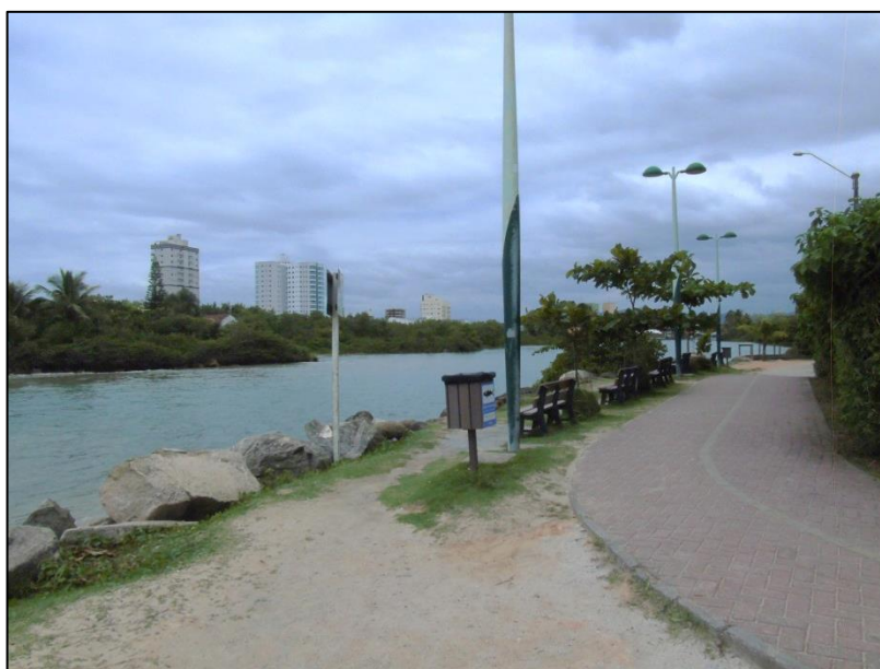
Figura 96: Uso de enrocamento para contenção de pista de caminhada (Parque Linear) no Rio Perequê – Meia Praia, município de Itapema.
