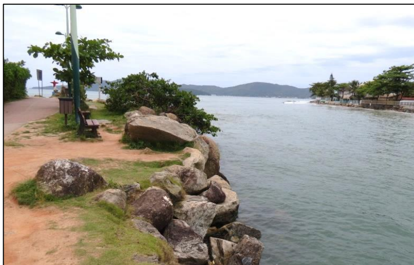
Figura 97: Uso de enrocamento próximo a foz do Rio Perequê, município de Itapema.
